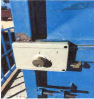
Foto 7: Sustrucción de Chapa (Módulo 4)
